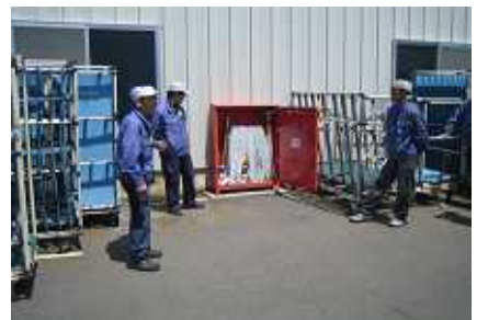
消火栓の使用説明
