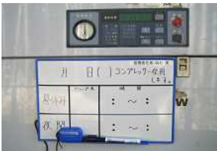
コンプレッサー節電管理板
